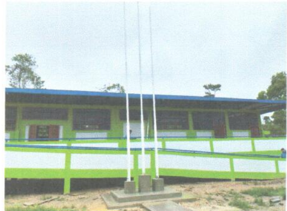
Toma N° 14: PINTURA LATEX EN MUROS INTERIORES Y EXTERIORES MAS MASTIL DE BANDERAS.
